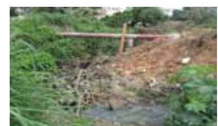
Degradação no córrego que passa dentro do Parque Brejinho. Daniela Vieira, 2011.
